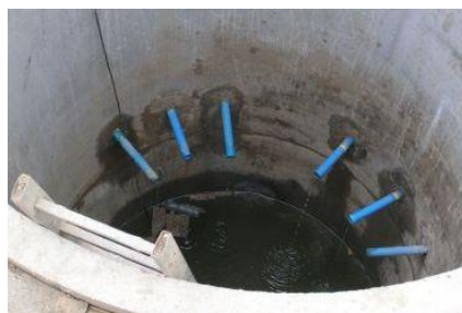
6. ábra. Fúrt szivárgócsövek kifolyói a gyűjtőaknában Készítette: nem ismert (Építő-szakmai cikkeek, 2012)
